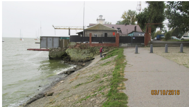
Рис. 48, 49. Пушкинская набережная - на всем протяжении берегозащитной стенки, нижний уступ подвержен разрушению.
