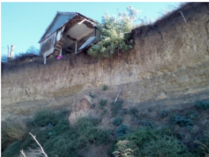
Рис. 43. Разрушение строения. Село Порт-Катон, ул. Морская (Азовский р-н).
