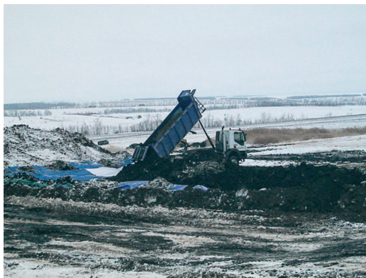
Порыв нефтепровода в Чертковском районе
